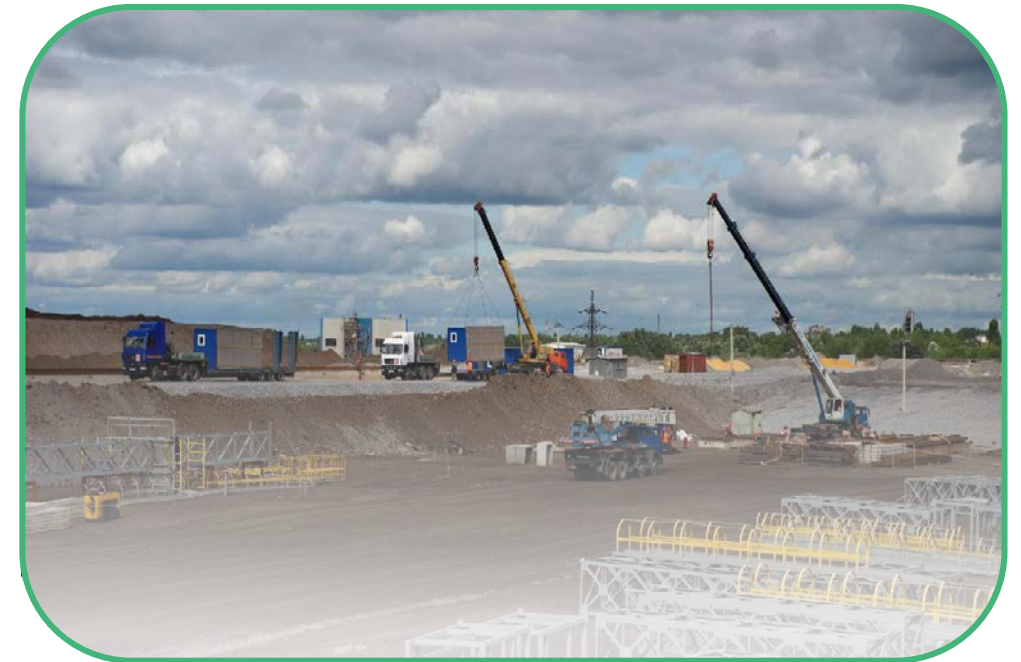
Участок переработки шлаков
